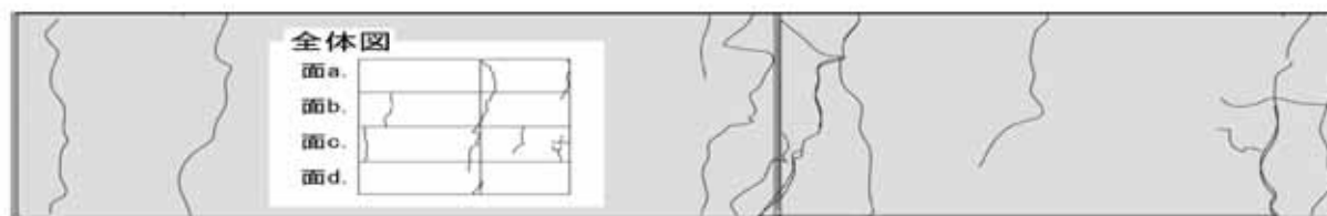
図 - 7 普通コンクリートのひび割れ図 (4面を重ねて表示・中央は全体図)
